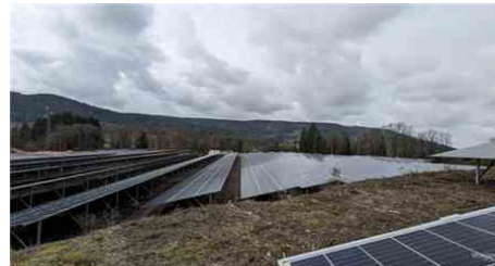
La centrale photovoltaïque de Dommartin-lès-Remiremont devrait se terminer début mars et la production d'électricité est prévue pour le 12 de ce mois. Photo Selma Filali
